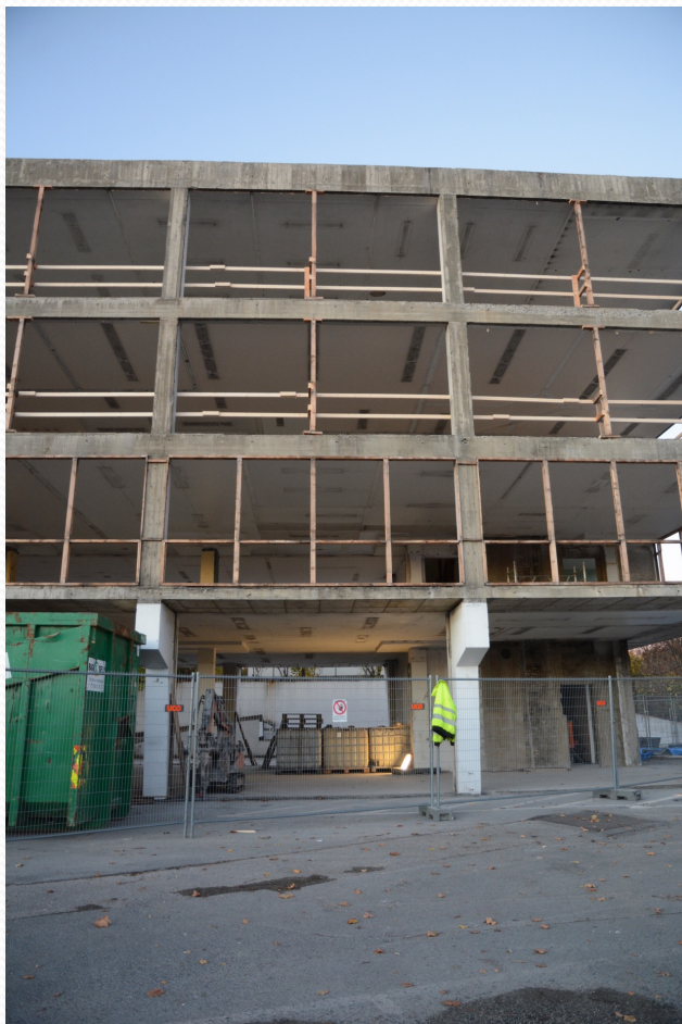
Ombruk av bæresystem
